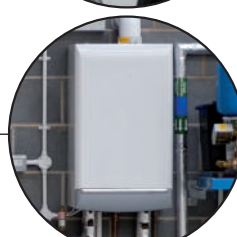
Caldaia e gruppi termici
